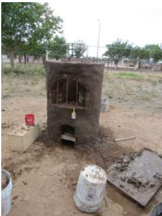
Imagen 52. La pared de la cámara de combustión terminada, arriba la estructura de varilla de la chimenea.
