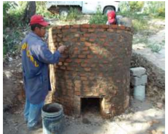
Imágenes 37 y 38. Muro de la cámara de productos o estiba y terminado de ésta.
