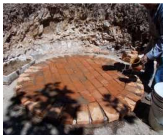
Imágenes 32 y 33. Marcando el sitio de construcción y formado de la base del horno.
