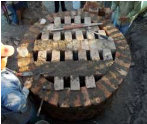
Imágenes 35 y 36. Armado del muro de la cámara de fuego y parrilla soporte de productos.
