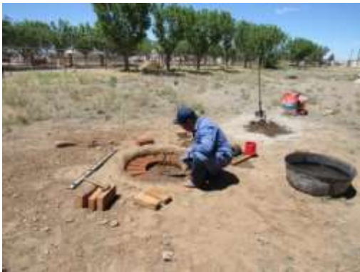
Imagen 48. Domingo Martínez Romero, terminando la base del horno Tekol kilitzin en la escuela Francisco Villa de Nuevo Casas Grandes, Chihuahua. Domingo nos dirigió en el proceso de construcción del horno.
